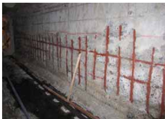
鉄筋は一部露出していた（左岸 側壁）
